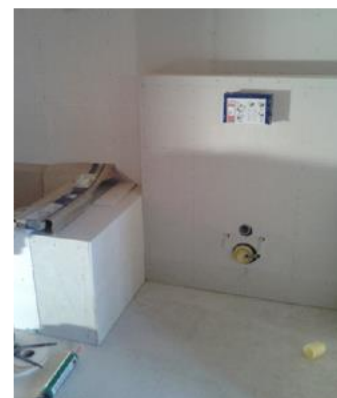
Attēls 5: Fermacell dēļi vannas istabā (foto Auraplan)
